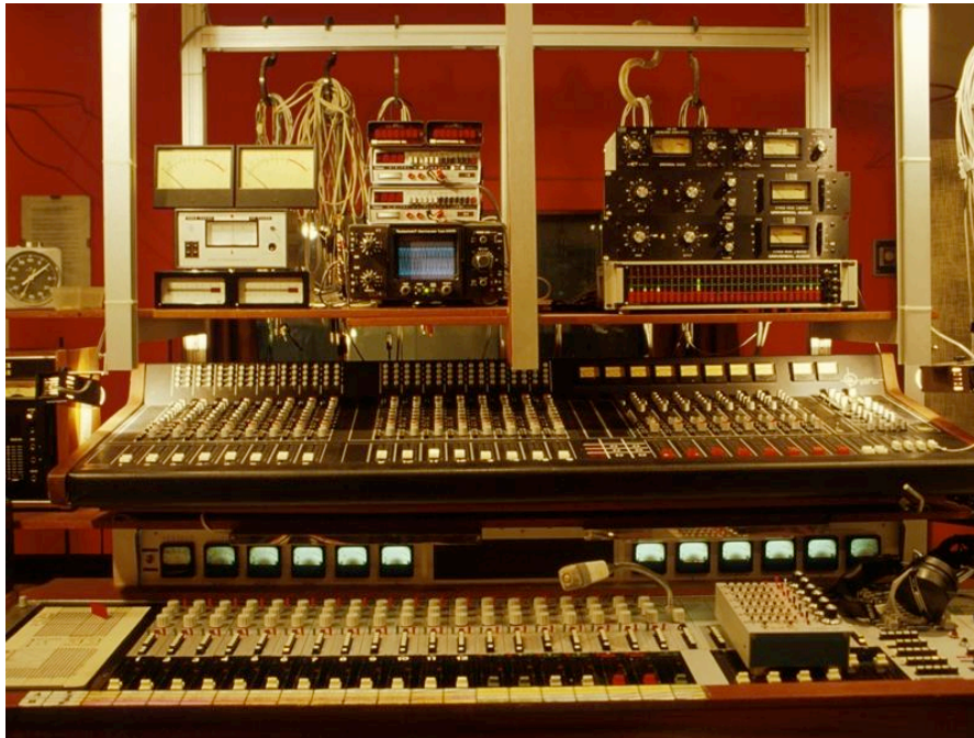
vue nord, double consoles, contrôles électroniques, analyseur, limiteurs-compresseurs
